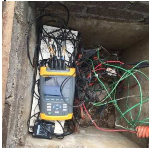
Figura 2: Conexión del analizador de calidad de potencia eléctrica en las tres líneas.
